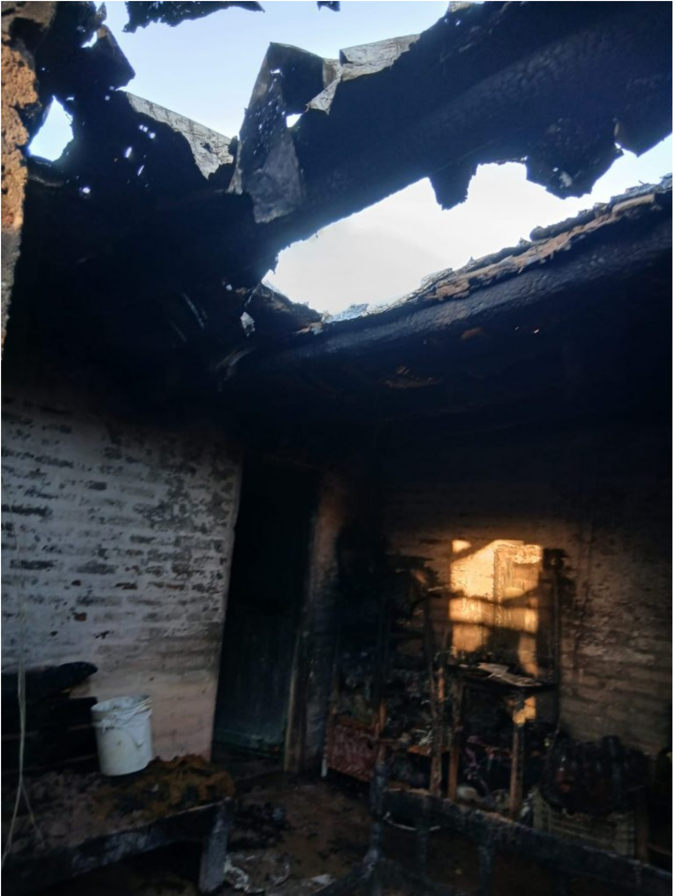
Un incendio desatado durante la madrugada en Rama Caída dejó daños y pérdidas totales en una vivienda.
