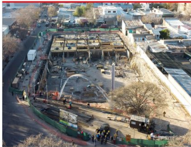
Más de 100 obreros trabajan todos los días en la construcción de un amplio edificio en el predio donde antes funcionó la vieja terminal de ómnibus de San Rafael. (Pág.5)
